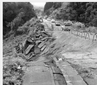
図2 損壊したマンホール
