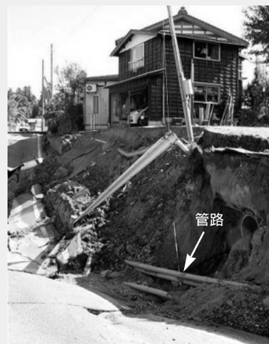
図1 道路崩壊により露出した管路
