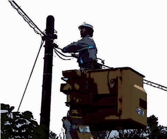
写真 電力線地絡時における作業者の危険性
