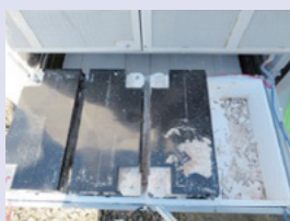
(a) RSBM-F (屋外設置型)の被害状況
