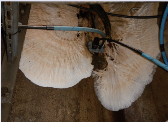
図4 白色析出物の発生状況
