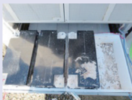
(a) RSBM-F (屋外設置型)の被害状況
