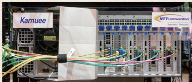
写真1 Interop Tokyo 2018のShowNetにおいて運用したソフトウェアルータ
