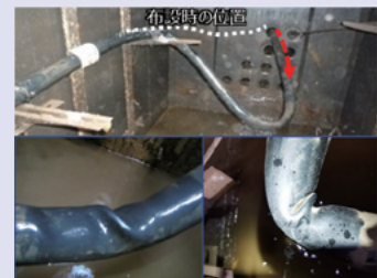
(c) ケーブルの屈曲, 変形
