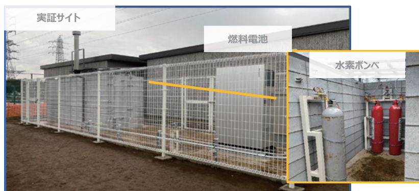
図4 純水素燃料電池盤
