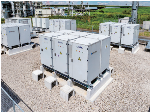
図3 系統蓄電池の一例(NTTアノードエナジー 和光蓄電所)
