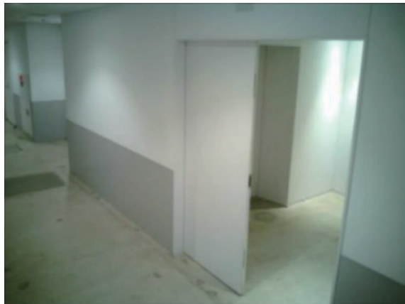
(a) 正常状態写真
